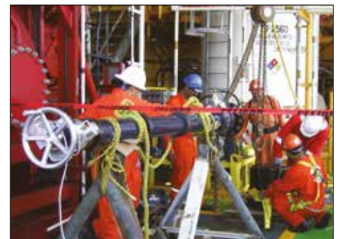
▼ Aplicación de hot tapping en alta mar con CHT2000.
